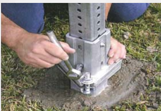
Postes Colapsíveis, e Perfis C
